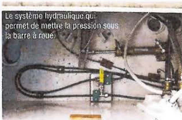
Le coffre sous la barre franche qui donne accès au système hydraulique.
